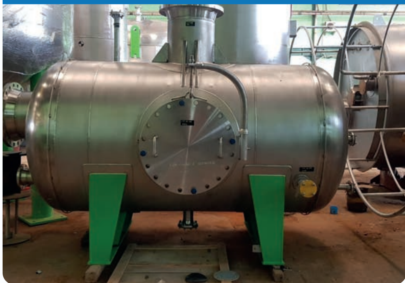
CONDENSATE SEPARATOR TANK
